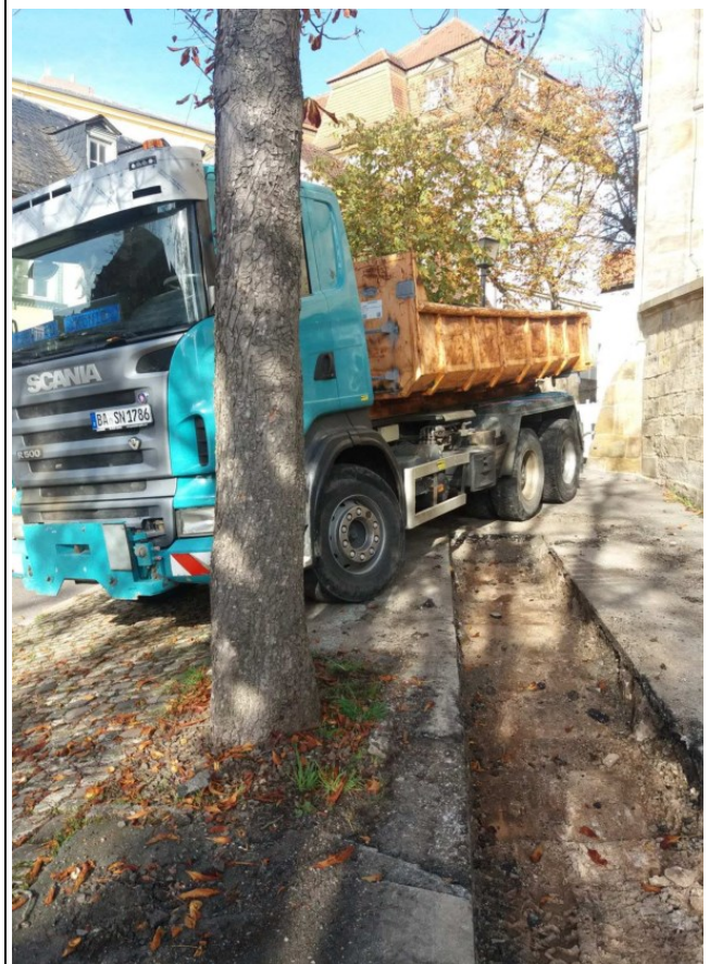
Bild 24: In nur 0,5 m Entfernung vom Stamm wurden im 1 m tiefen Leitungsgraben alle Wurzeln abgegraben, so dass ein Wurzelverlust von 25-45% entstand
