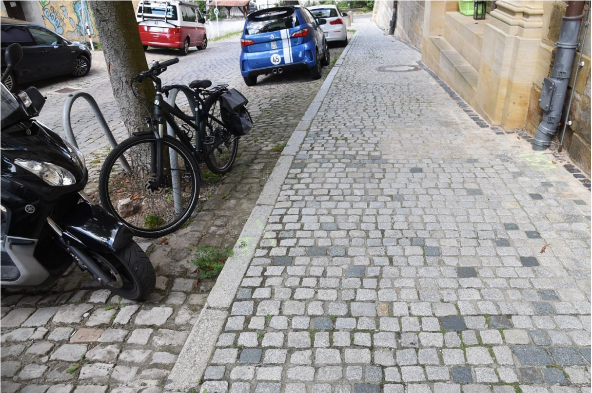
Bild 41: Der Standort ist durch die ausbetonierten Fugen des Pflasters extrem versiegelt. Es ist geplant die in der Straße verlaufende Wasserleitung zu erneuern, so dass Wurzelschäden zu erwarten sind
