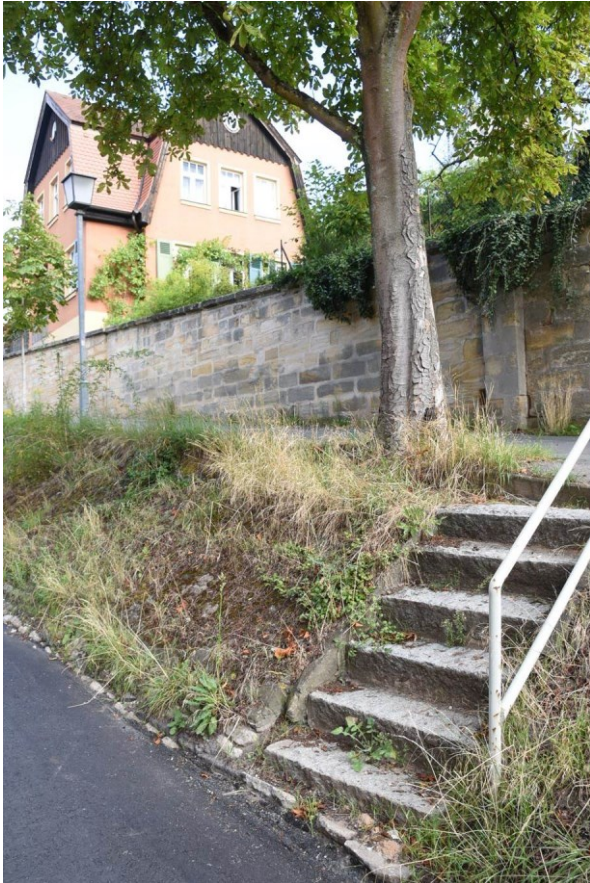
Bild 9: Nach der bisherigen Planung soll die gesamte Böschung erneuert werden, wodurch weitere Wurzelschäden zu erwarten sind
