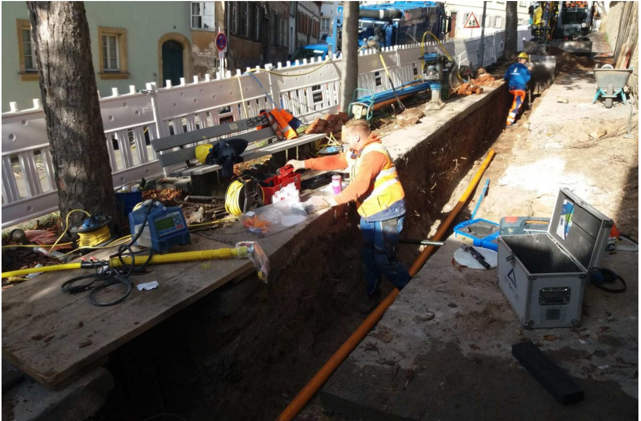
Bild 3: Im Leitungsgraben wurden alle vorhandenen Wurzeln bis 1 m Tiefe abgegraben. Schutzmaßnahmen gemäß DIN 18920 wurden nicht berücksichtigt, da eine Fällung der Baumallee vorgesehen war.
