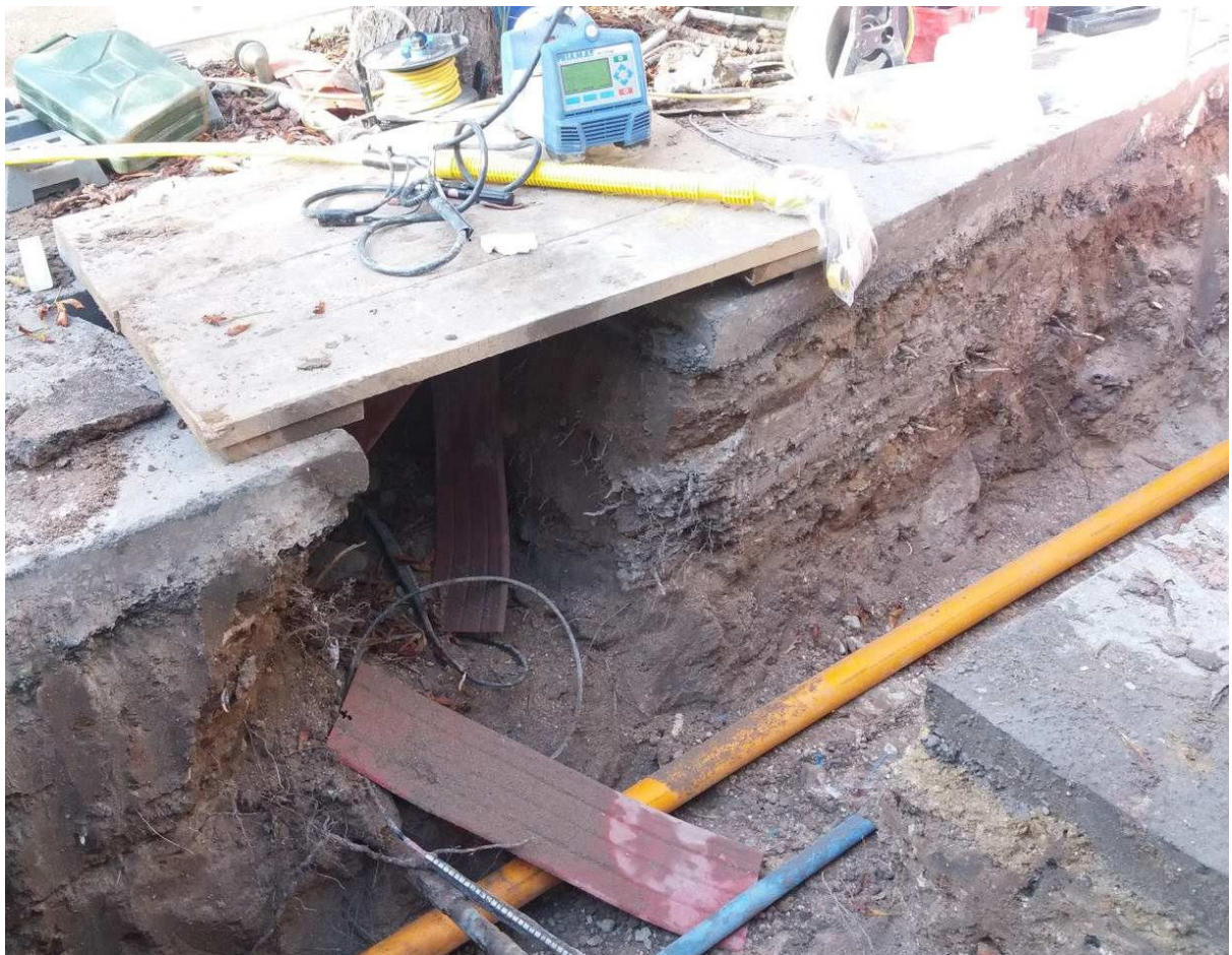
Bild 4: An diesem Baumstandort queren Leitungen zur Straße, so dass ein Großteil der Wurzeln direkt an Stamm abgegraben wurden
