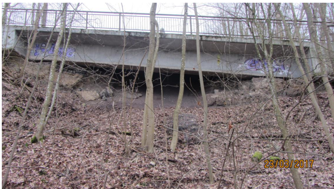
Abrutschungen unterhalb der Hangbrücke 2017
