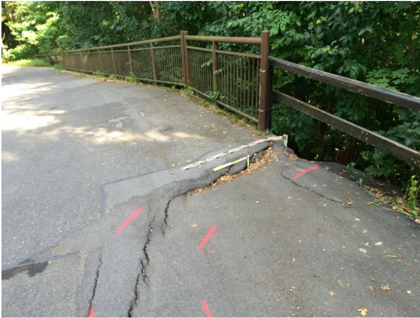
Rutschungskörper an der Hangbrücke
