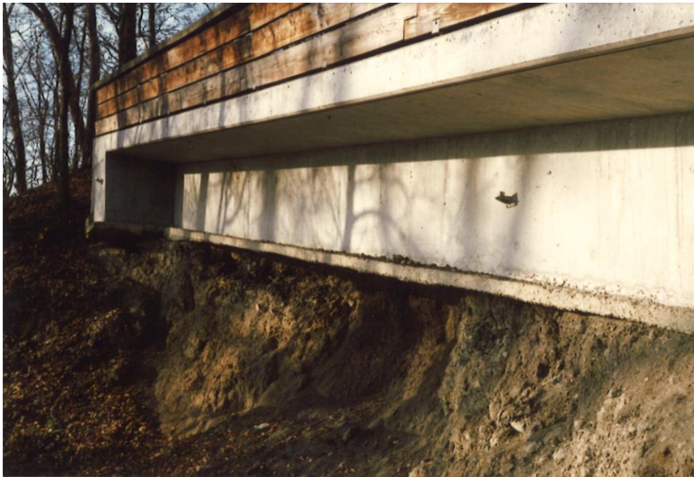
Abrutschungen unterhalb der Hangbrücke Aufnahme von 1982
