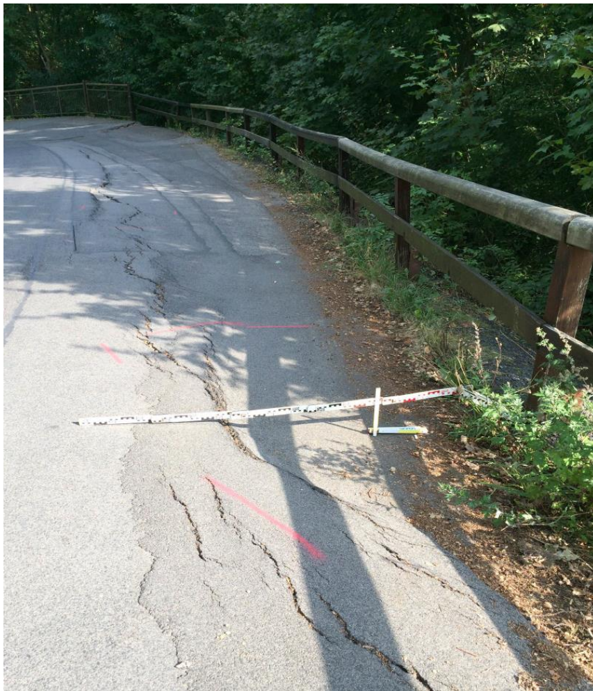
Verformungen der Fahrbahn
