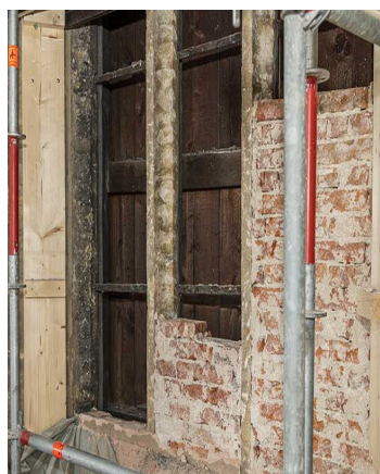
Öffnung der Vermauerung / Fund der gotischen Rippen
