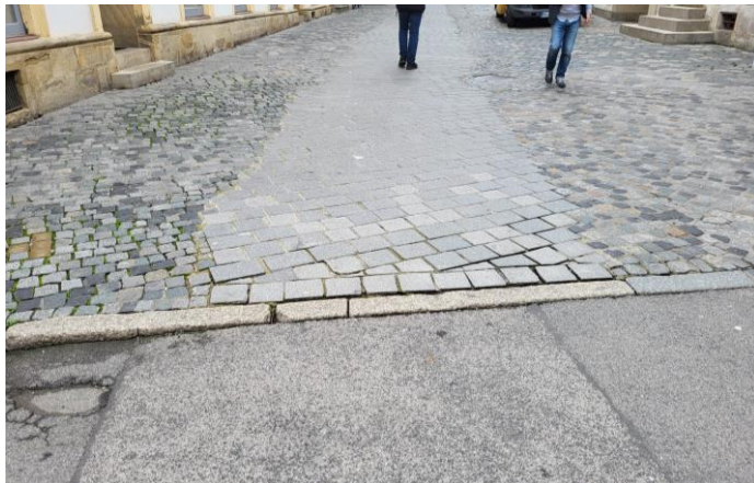
Oberflächenbelag mit Stolpergefahr (GMA 2022)
