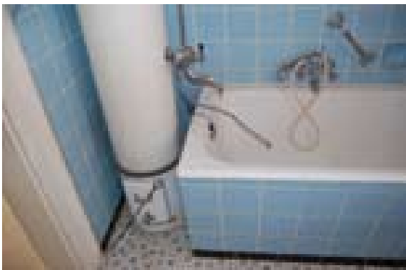
Abb. 11.1: Hoher Sanierungsbedarf besteht u.a. im Ehard-Haus, das daher zum großen Teil leer steht.
