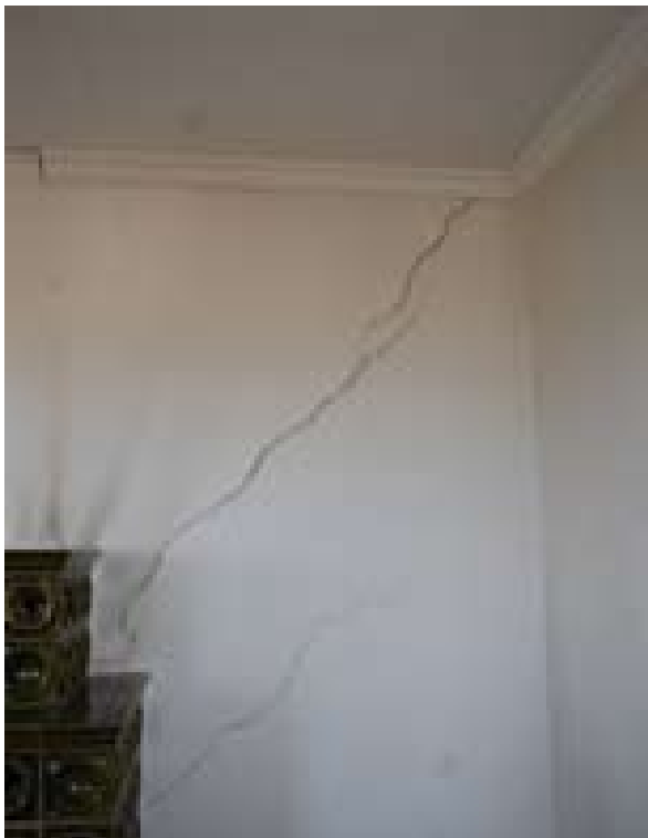
Abb. 4.2: Die Risse im Inneren der Villa Remeis sind Beleg für die erheblichen statischen Probleme.
