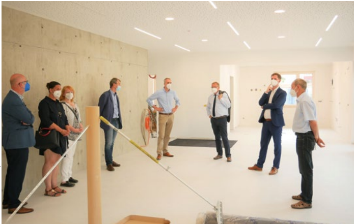
Beim Baustellenbesuch von Oberbürgermeister Andreas Starke und Bürgermeister und Sozialreferent Jonas Glüsenkamp beeindruckt die Architektur mit ihren großen, lichtdurchfluteten Räumen.
