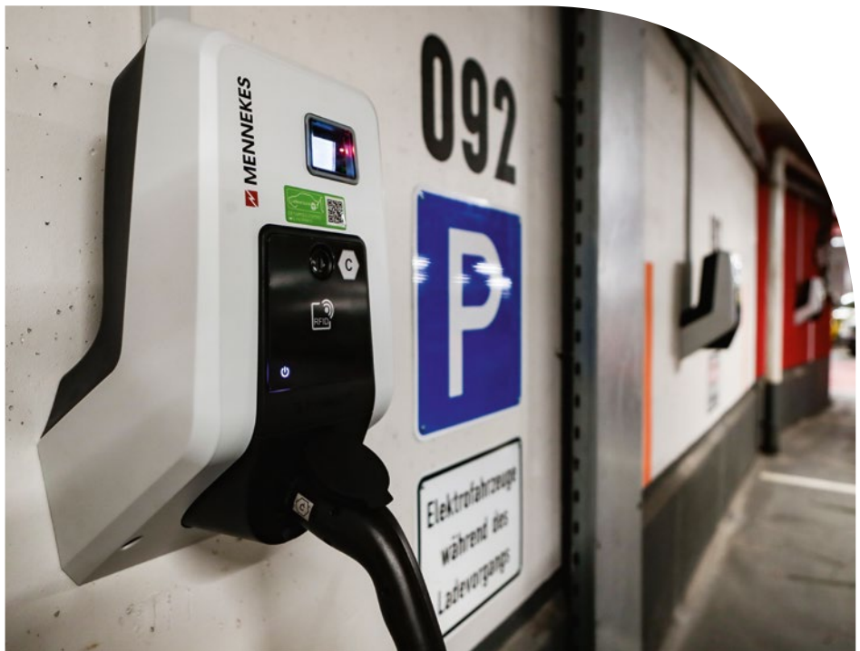
Ladestationen in der Tiefgarage Zentrum Nord Georgendamm.
