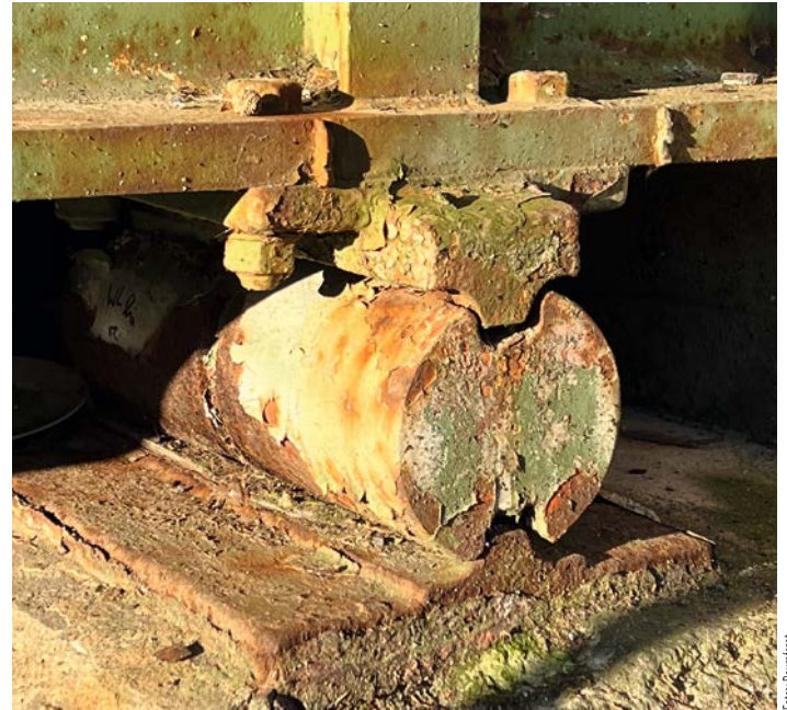
Insbesondere am Unterbau der beiden Brückenköpfe weist die Markusbrücke inzwischen erhebliche Schäden auf.
