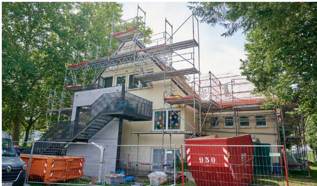
Das Schulhaus im Bamberger Stadtteil Bug ist eine Außenstelle der Grundschule Bamberg-Kaulberg. Der Dachstuhl war noch original aus den 1960er Jahren und erhält aktuell eine Generalüberholung.
