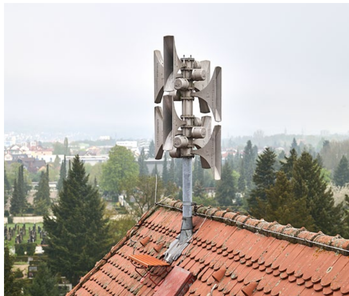
Sirenenanlage auf der Luitpoldschule.
